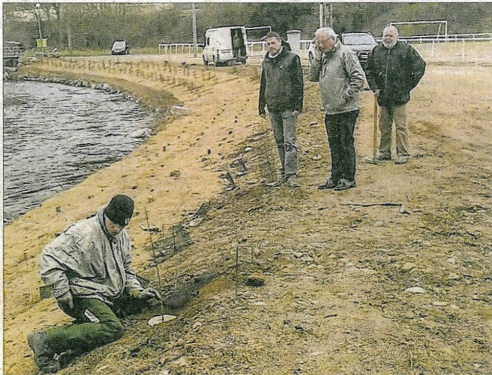
■ Les adjoints François Laurent (1 er à droite) et Jean-Paul Combe (2 e à droite) ont suivi de près l'avancement des travaux. Photo Michèle DEVEAUX
